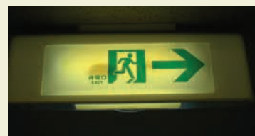
劣化した表示板の例
