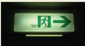
正常な表示板
