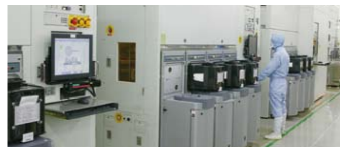
半導体工場では、クリーンルームの加湿方式の変更や、ウェハ搬送エリアだけの空気清浄度を高める局所空調を採用しました。(CO 2 削減効果4,100t-CO 2 /年)
