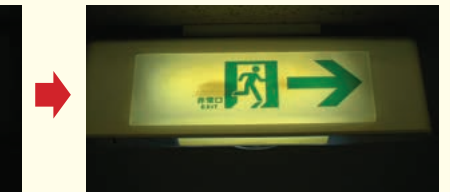
劣化した表示板の例
