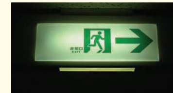
正常な表示板
